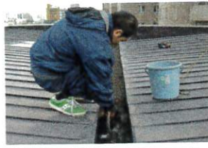
ダクトに泥がたまっている屋根も
