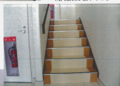
階段ホールの随所に 消火設備が設けてある
