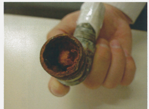
塩化ビニールにコートされていないエルボー（つなぎ部分）の内部が赤錆で腐食している
