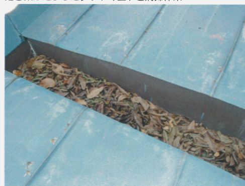
落ち葉がたまったダクト(上)と清掃作業
