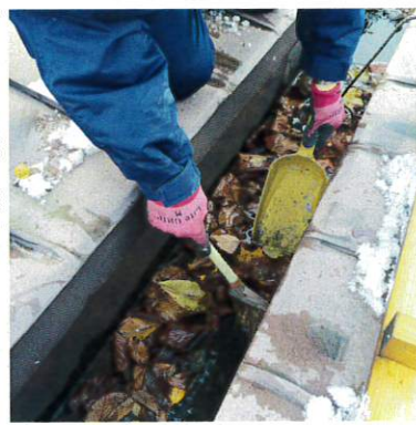
ダクトには落ち葉や大きなゴミがたまっていることも
